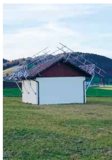
Pumpwerk Zisterwis, Wallenwil
