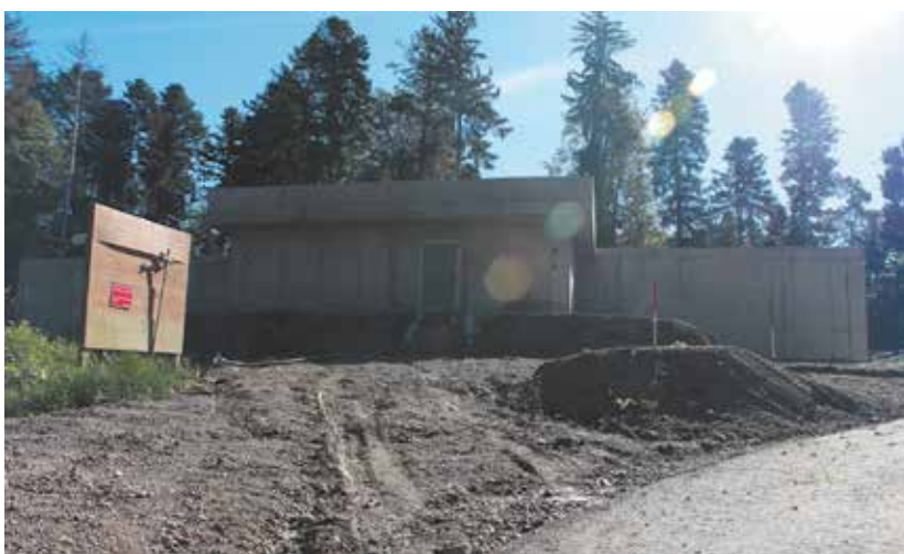
Bald wird nur der vordere Teil mit dem Schieberhaus des neuen Reservoirs Fohrenberg sichtbar sein.
