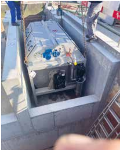
Einsetzen der Trommelsiebe zur maschinellen Vorklärung.
